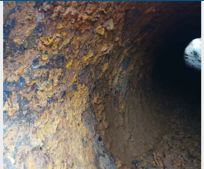
Korrosion in einer TW-Stahlleitung
